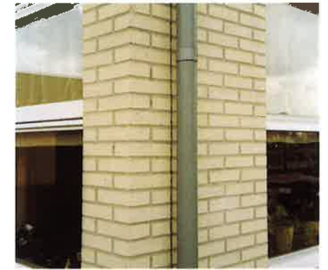
Metselwerkdilatatie achter HWA
