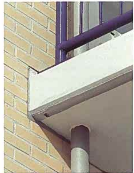
Figuur 14. Thermische spanningen in het metselwerk kunnen ook het gevolg zijn van verschillen in lengteverandering van de ermee verbonden constructies zoals lateien, kolommen, e.d.
